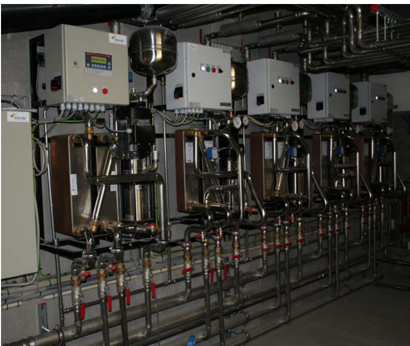
De installerede køleunits i sendestationen i Videbæk
